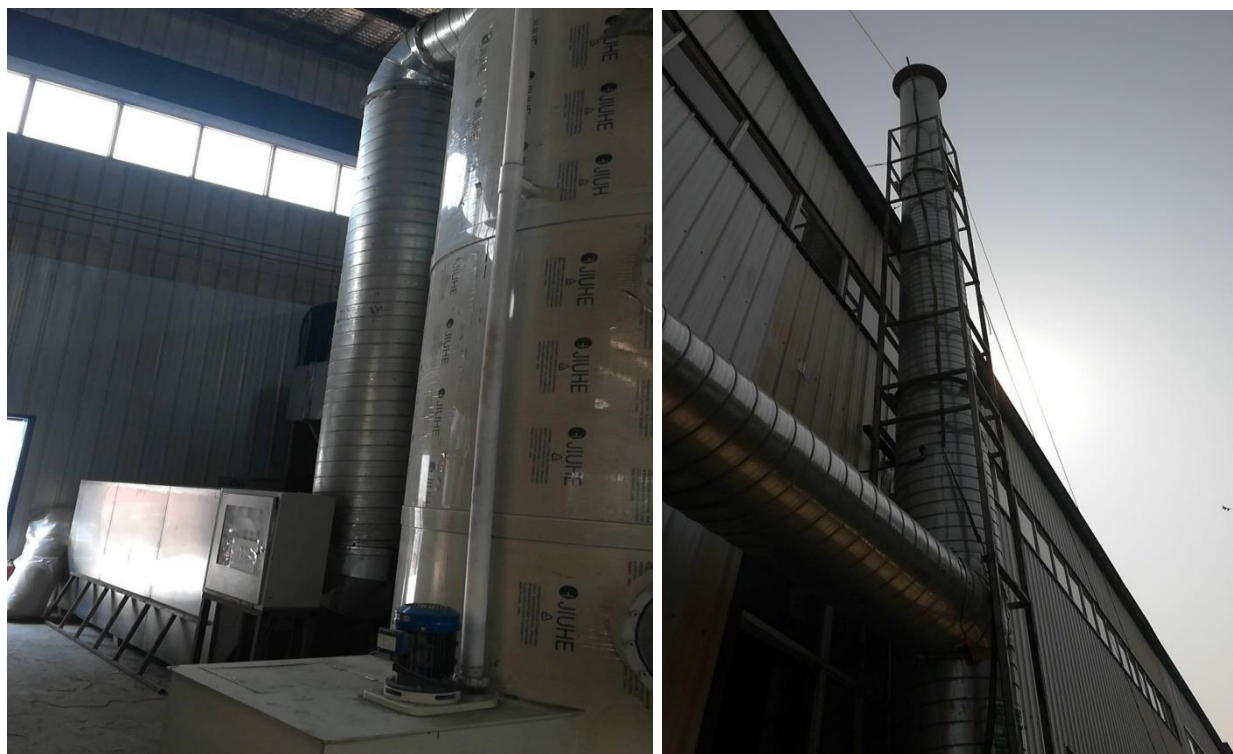
图 4 废气治理设施图片
